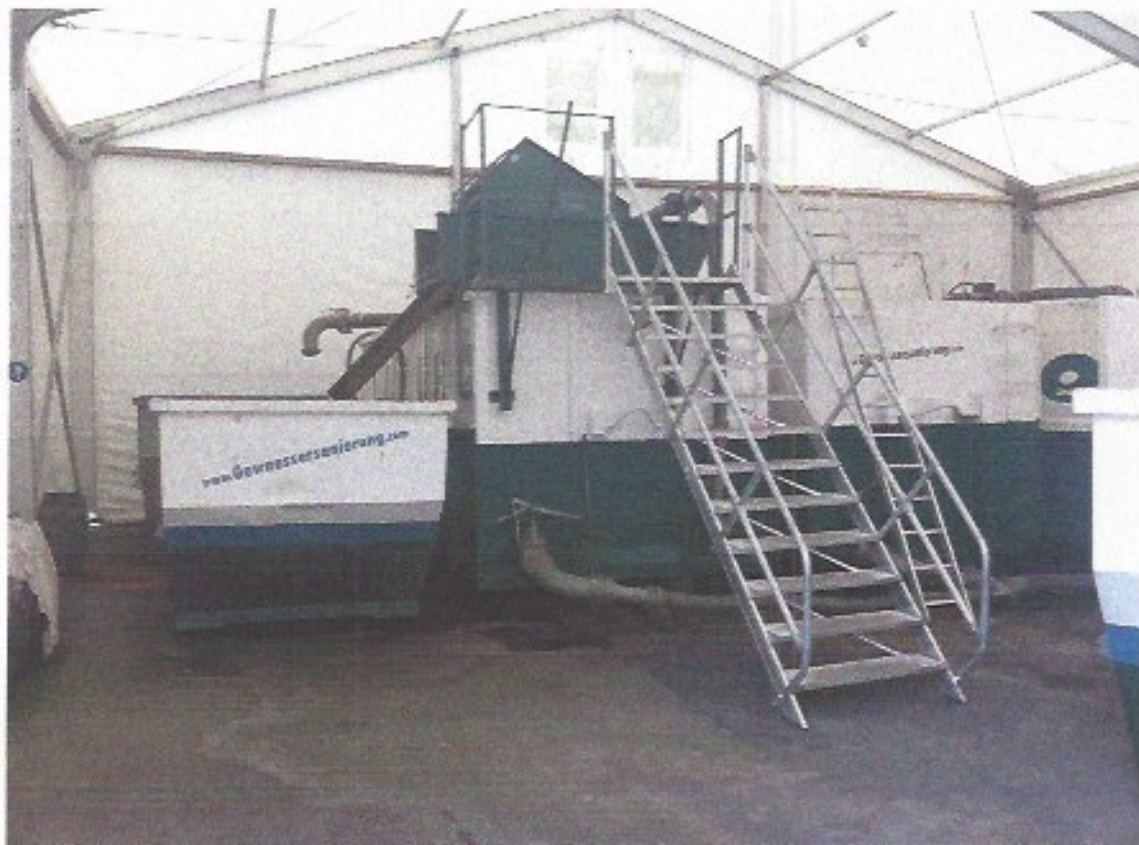
Schwingsieb auf Vorlagencontainer und Rechengulcontainer
