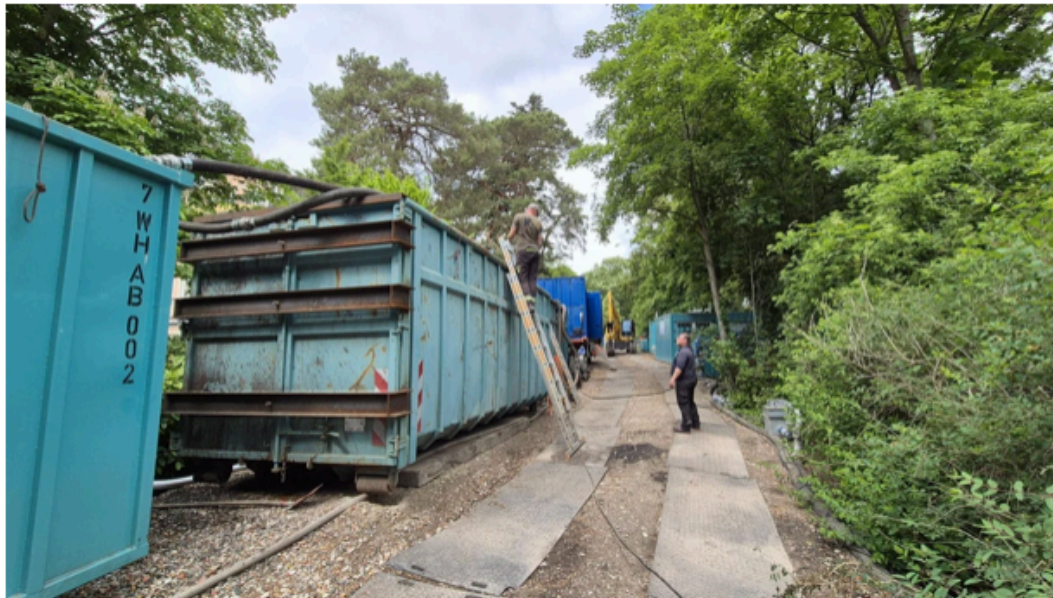
Mehrere Container stehen auf der Baustelle für den Abtransport des Schlammes bereit. © Katrin Lange | Katrin Lange
